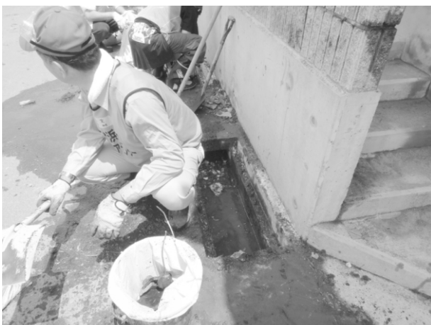
側溝掃除はなかなか進まず臭いもきつい
